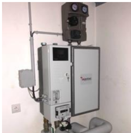
Sous-station jusqu'à 70 kW
